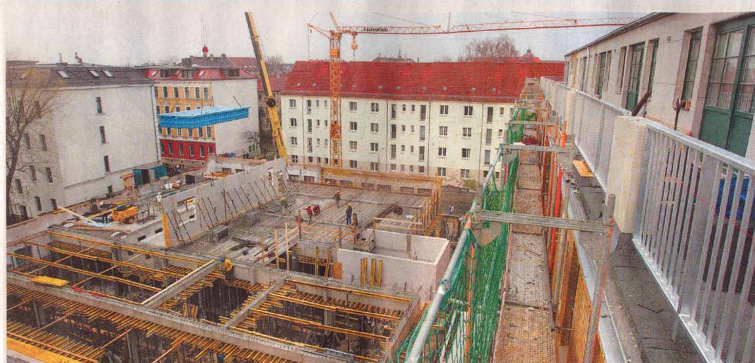
Ein 15 Meter langes Schwimmbecken schwebt über der ehemaligen Zahnradfabrik. Es wird im ersten Stock eines Neubaus montiert, bevor dieses Haus weiter in die Höhe wächst.
