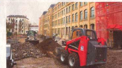
Hinter dem Süd-Center (rechts) entsteht zurzeit eine Zufahrt zu den Mieter-Parkplätzen. Fotos: André Kempner
