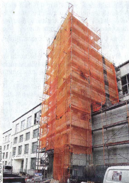
Fast fertig: In der Weißenfeller Straße 84 wird nur noch der Fahrstuhlurm saniert.
